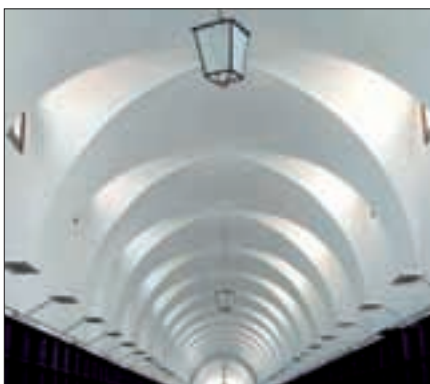
Dettaglio del sistema di illuminazione della sala principale della Nuova "Manica Lunga"
